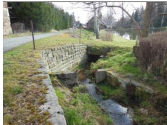
Obr. 12. – požární nádrž a nefunkční stavidlo
