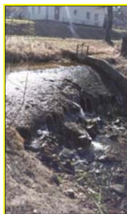
Obr. 14 - Polorozpadlý jez na ř. km 10,32
