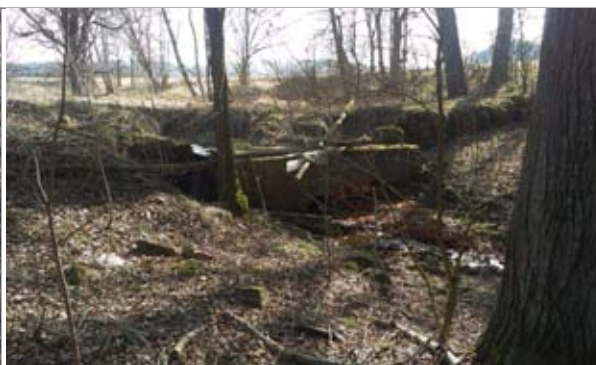
Obr. 2 - Pohled proti proudu – poškozený trubní propustek na konci úseku
